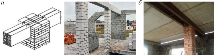
Рисунок 5.13 — Отдельные опоры (кирпичные столбы) с опиранием прогонов: а — железобетонного, б — металлического из прокатных профилей
